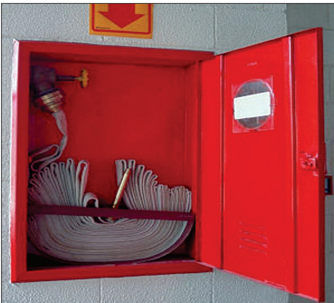
Figura 4: Sistema de hidrantes
