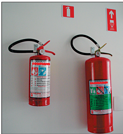
Figura 9: Extintor de incêndio
