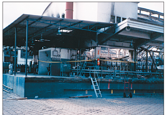
Figura 7: Isolamento do local sinistrado
