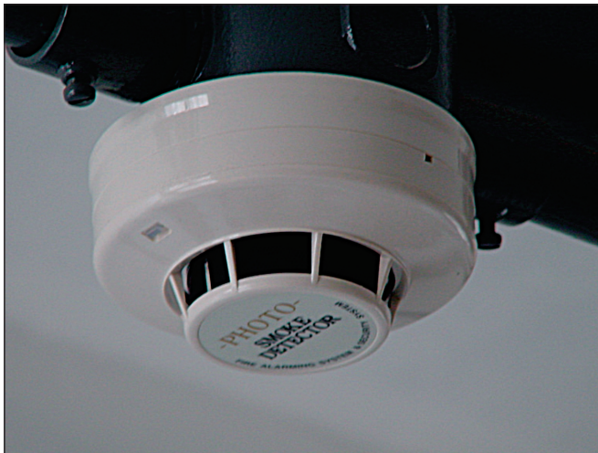
Figura 57: Detector de incêndio
