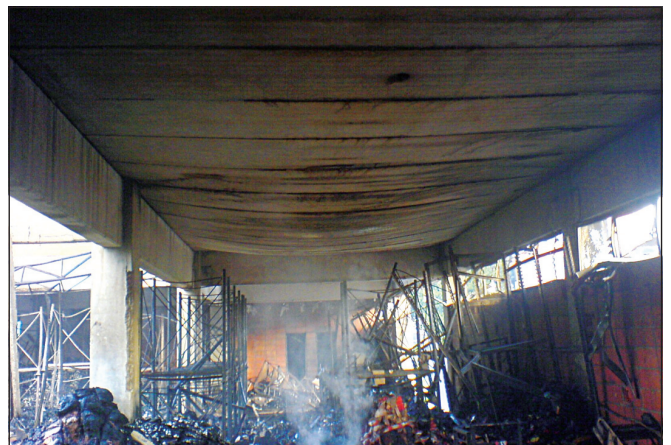
Figura 15: Incêndio no pavimento
