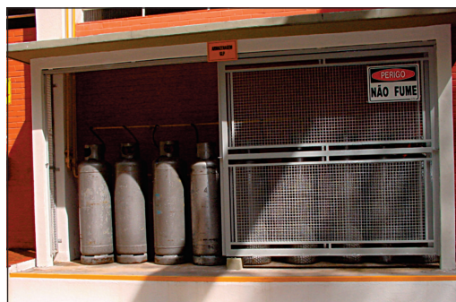
Figura 77: Bateria de GLP
