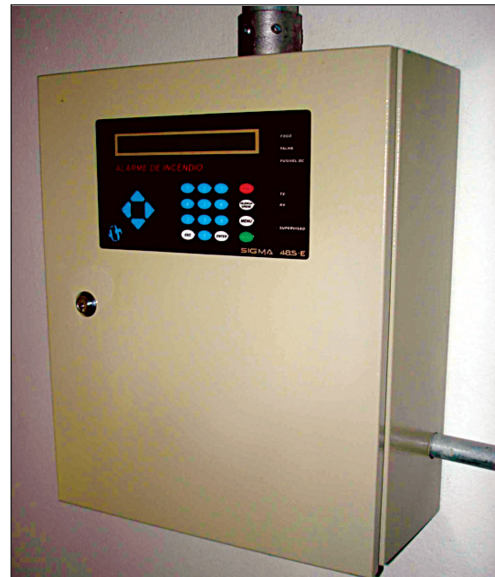
Figura 60: Central de alarme
