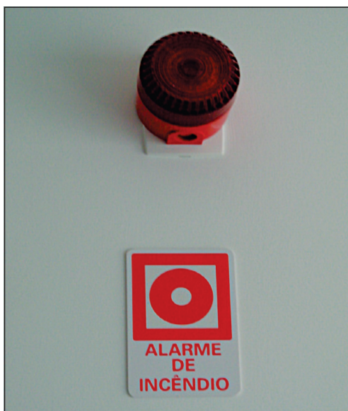
Figura 59: Detalhe de sirene
