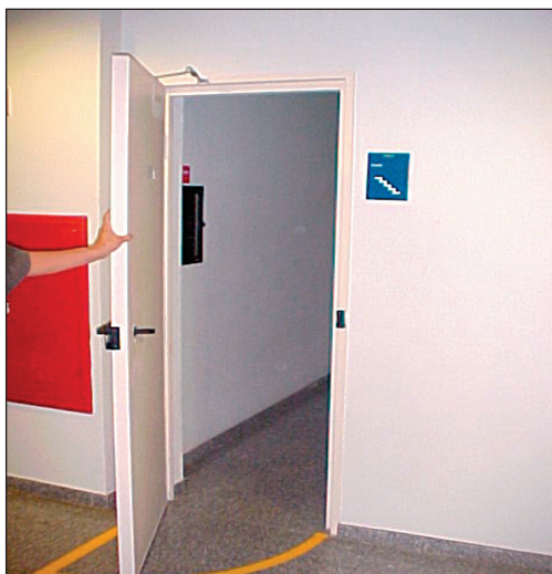
Figura 52: PCF em corredor
